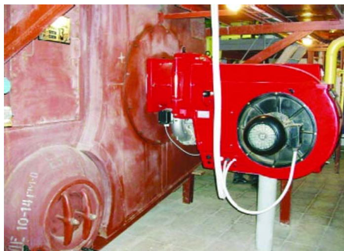
г. Кемерово. Котел ДЕ-10 с газовой горелкой G70 исп. SF
